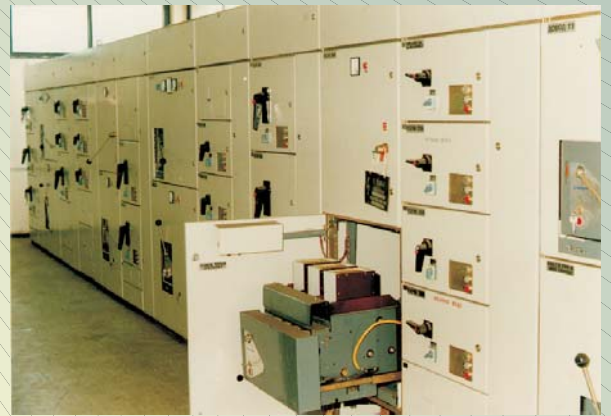
Postrojenje sastavljeno od BP3 ploče
